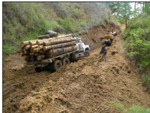
Foto 4: falta de trabajos de ingeniería en la construcción de caminos forestales
